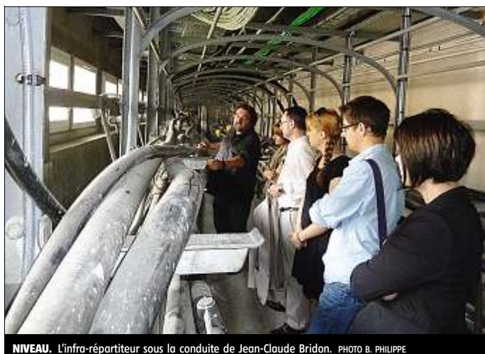
NIVEAU. L'infra-répartiteur sous la conduite de Jean-Claude Bridon. PHOTO B. PHILIPPE
